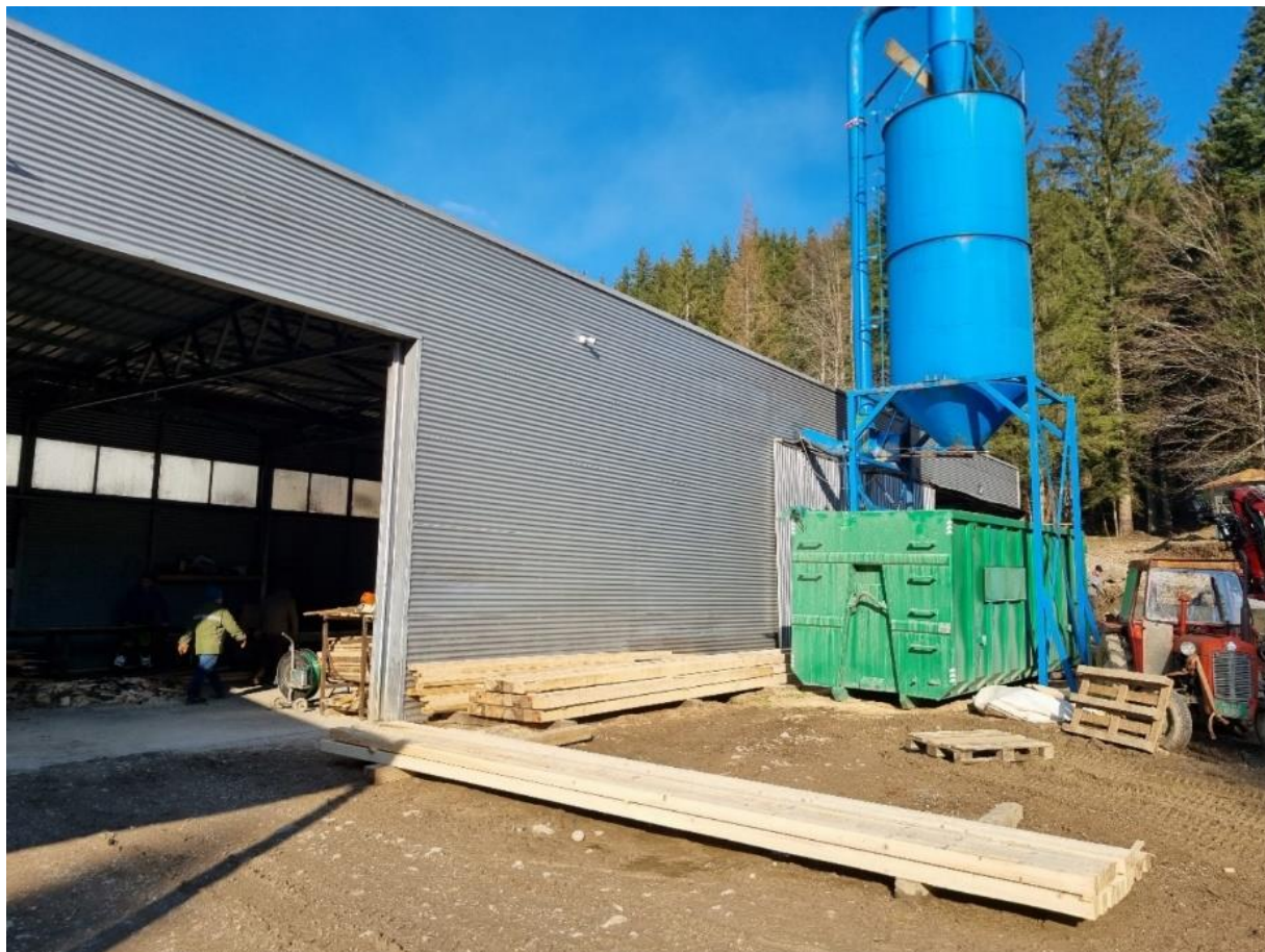
Silos za pilotinu iz sistema za otprašivanje predmetnog pogona i namjenski pokretni kontejner za odlaganje piljevine
